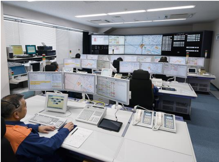
(高機能消防指令センター)
