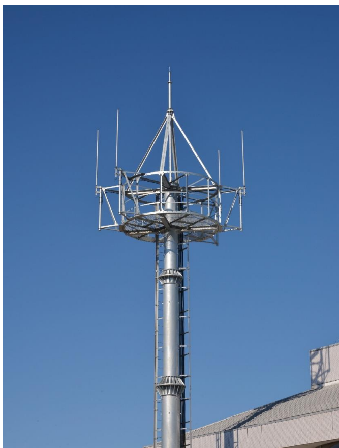
(消防救急デジタル無線アンテナ塔)
