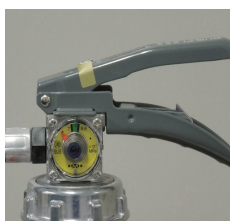
× 安全栓の脱落
