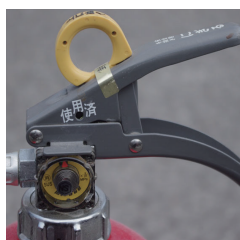
× 表示装置の脱落
