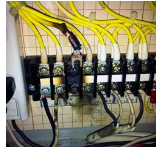
分電盤からの出火事例
