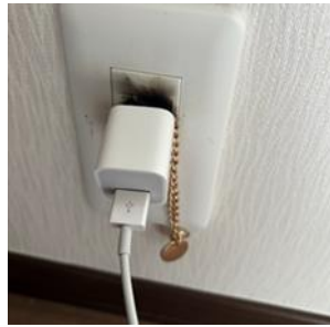
コンセントの間にアクセサリが挟まりスパークした事例
