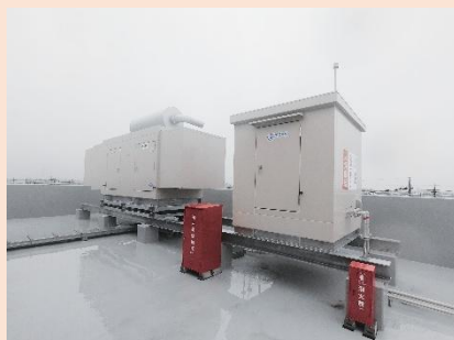
非常用発電機。地下タンク（軽油 5000ℓ）と接続し、停電時でも消防指令センターの72時間稼働が可能。
