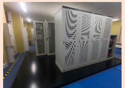
サーバー室。免震構造の採用により地震の揺れを軽減し、継続して119番通報受付を行うことが可能。
